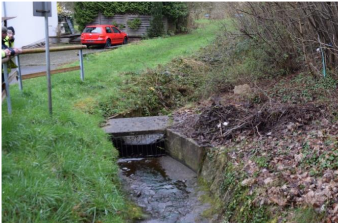
Einlassbereich vor der Verrohrung am Birkenweg
