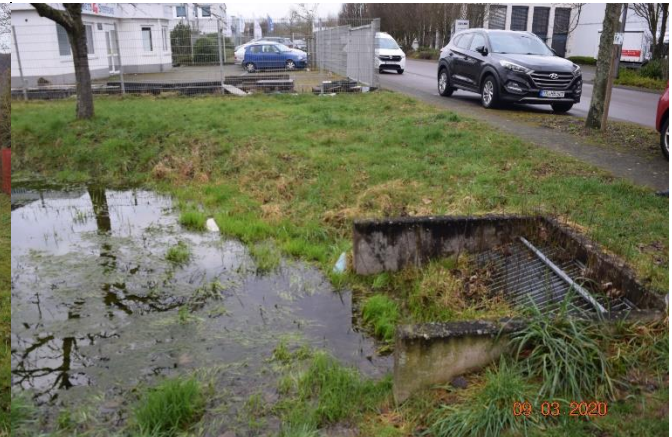
Einstau am Einlassbauwerk zwischen Im Paesch 10 und 11
