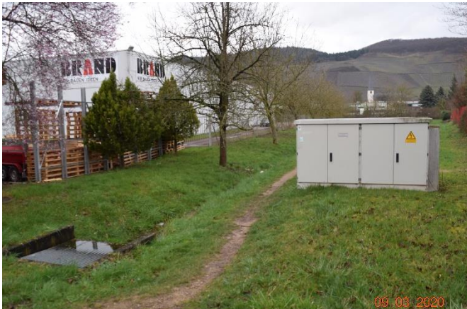
Auslassbauwerk am Weg zwischen Im Paesch 1 und 2
