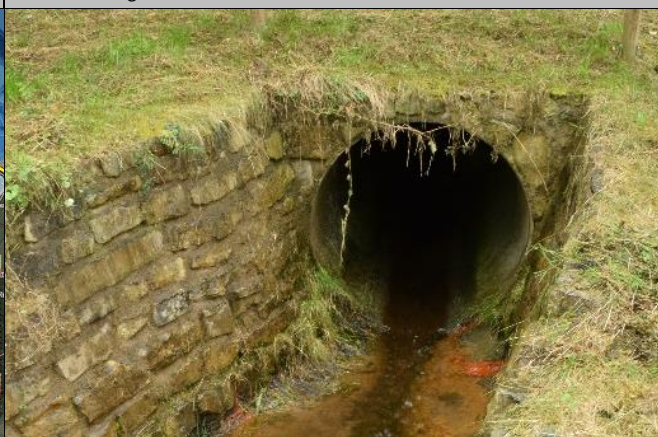
Verrohrung des Baches unter der Autobahn
